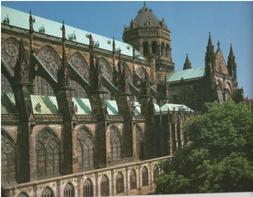
Figura 177: cobertura com telhas de cerâmica do coro da Igreja de Long Melford; telhado com placas de ardósia da Catedral de Estrasburgo.
