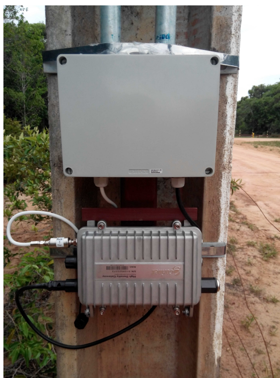
Figura 43 – Visão frontal da caixa hermética e suporte de fixação do modem BPL no posteamento.
