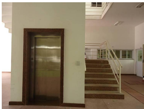
Figura 18 – Elevador desativado. Fonte: Própria.
