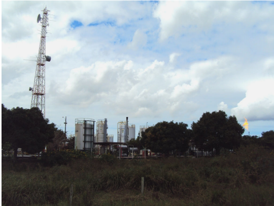
Figura 28 - Tanques de coleta de óleo na ECT Santa Luzia (foto do autor)
