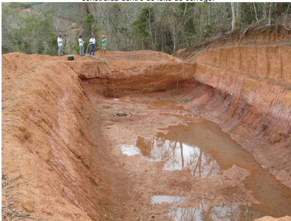
Figura 43 – Estruturas de reservação de água em partes altas da bacia do Sossego.
