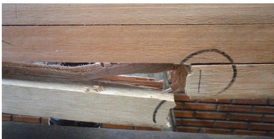
Figura A5 - Forma de ruptura da Viga 05 de Eucalipto
