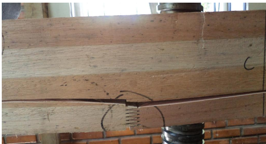
Figura A2 – Forma de ruptura da Viga 02 de Eucalipto
