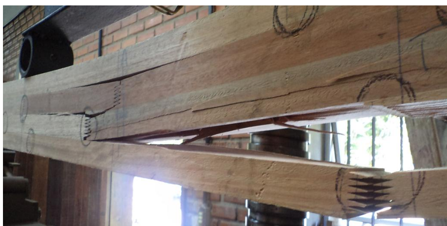
Figura A11 - Forma de ruptura da Viga 11 de Eucalipto
