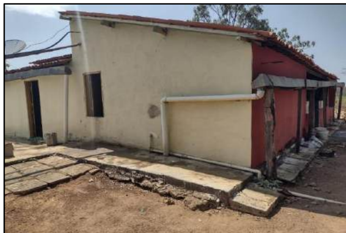
Imagem 5: Sistema de calhas para coleta de água
