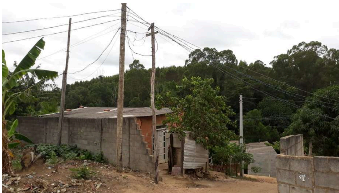
Figura 52: Modelo de distribuição de energia elétrica clandestina em 2019
