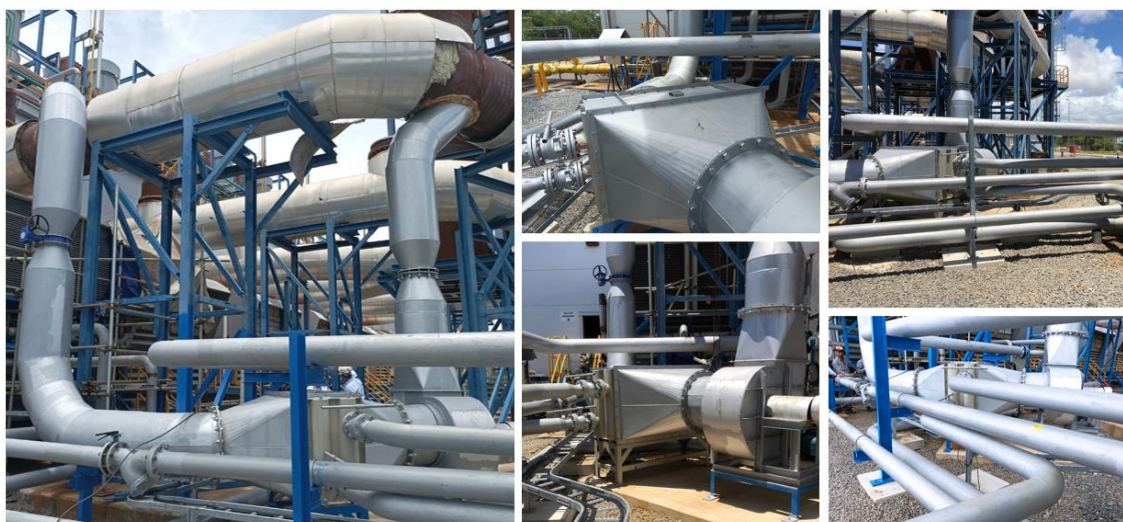
Figura 3.9 – Trocador de calor (TCR) Tubal modelo Recuperador de Gás e ventilador centrífugo (VTR) Motovent modelo CLLIK 600
