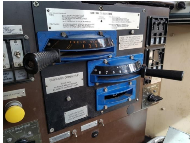
Figura 2.5 - Manípulos de freio dinâmico, acelerador e reversora da locomotiva
