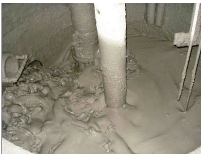
Figura 3: Tanque de bombeamento
