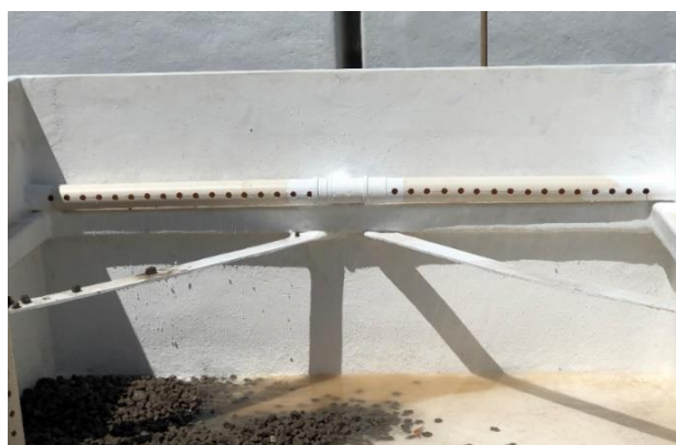
Figura 3.48: Tubulação de distribuição do esgoto na entrada do FRE. Fonte: Autoria própria.
