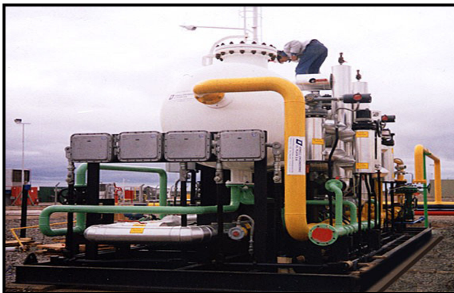
Figura 10. Separador trifásico em um campo de petróleo onshore (FADEPE, 2008).
