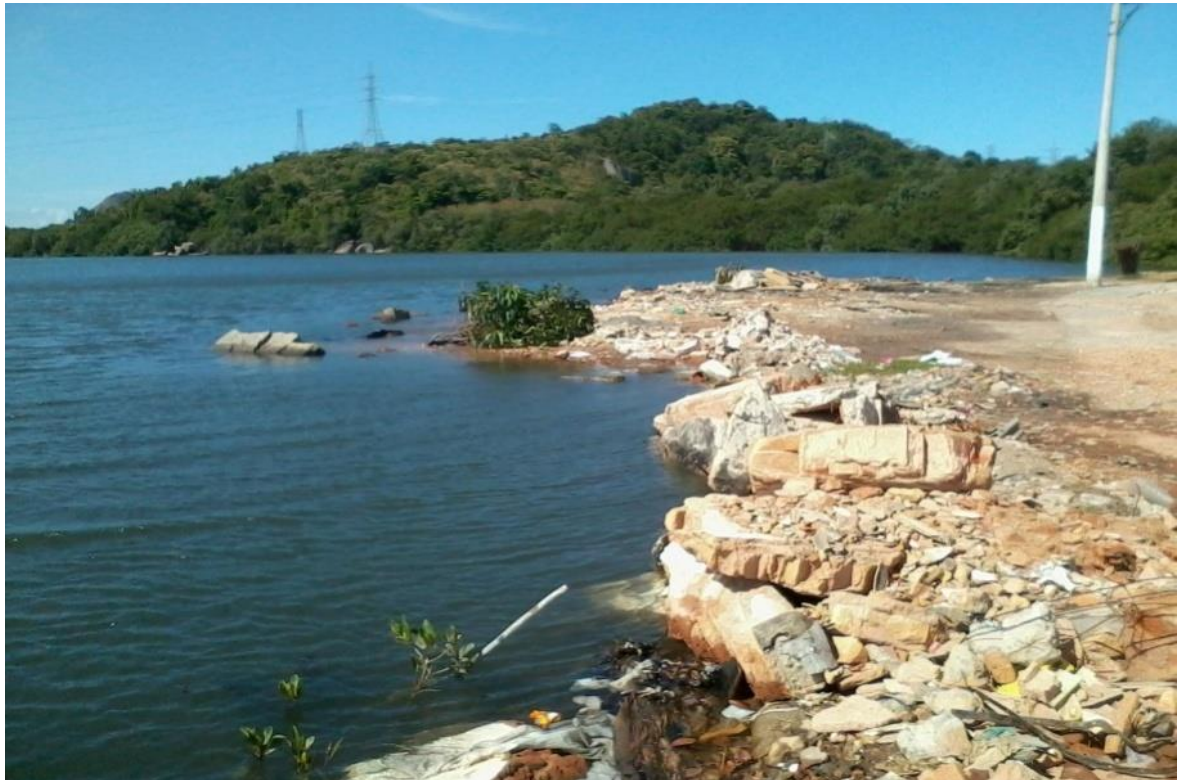
Figura 09: Margem do rio Aribiri que sofre com o processo de erosão e de acúmulo de lixo doméstico. Vila Velha/ES, 2015. Foto: autora.
