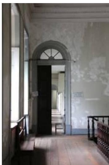
Figura 54 – Foto dos corredores de acesso às enfermarias do segundo pavimento. As paredes necessitam de pintura e tratamento contra umidade. Fotografia: Marco Antônio Cavalcanti. Fonte: Jornal O Dia, 2014.
