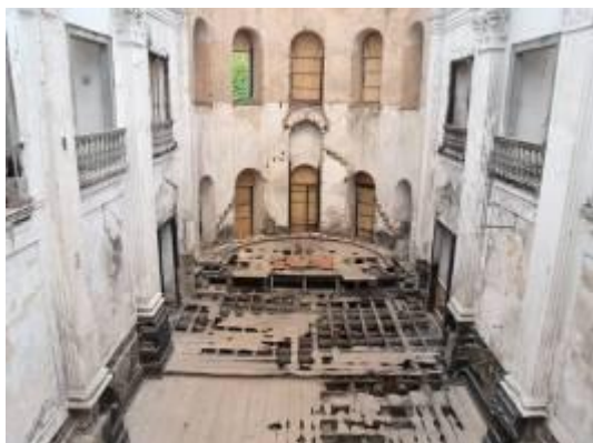
Figura 113 – Interior da Capela incendiada em 2011. Fotografia: Isabele Rangel (2013). Fonte: Notícias R7.
