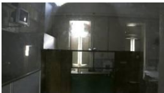
Figura 49 – Fotografia apresenta uma das salas administrativas de atendimento aos pacientes. O ambiente apresenta problemas nas paredes com presença de umidade. As divisórias não possuem um padrão estético poluindo a visualmente o ambiente. Fotografia: Marco Antônio Cavalcanti. Fonte: Jornal O Dia, 2014.
