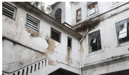
Figura 52 – Nos fundos da edificação há uma grande quantidade de umidade nas paredes, muitas machas, sujidades, descolamento de reboco e presença de vegetação na fachada. Fotografia: Marco Antônio Cavalcanti. Fonte: Jornal O Dia, 2014.
