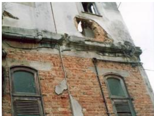
Figura 153 – Anexo construído no prédio 1. A construção de alvenaria de tijolos se encontra em estado de conservação ruim. Fotografia: Desconhecido. Fonte: Plano Diretor, 2004.
