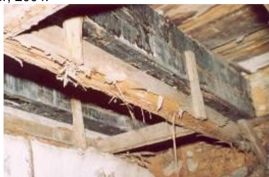
Figura 149 - Barrote do Prédio 3 com ataque de xilófagos. Pode-se observar o péssimo estado de conservação da estrutura e a falta de forro no teto. Fotografia: Desconhecido. Fonte: Plano Diretor, 2004.
