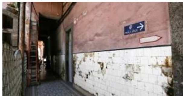
Figura 167 – Detalhe do Corredor de Acesso aos pavilhões. Nota-se danos no revestimento, pintura e nos azulejos. Fotografia: Marco Antônio Cavalcanti, 2013 Fonte: Cavalcanti, 2013.
