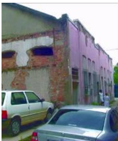
Figura 159 – O prédio da Esterilização apresenta aspecto degradado e não apresenta características estilísticas que harmonizam com o conjunto original. Fotografia: Desconhecido. Fonte: Plano Diretor, 2004.
