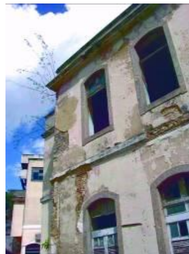
Figura 147 – Mais uma vista do Prédio 3. Nota-se que grande parte da fachada e da estrutura comprometida. Fotografia: Desconhecido. Fonte: Plano Diretor, 2004.
