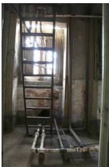
Figura 53 – Detalhe das Instalações que se apresentam precárias e necessitam de reparo urgente. Destaque para a janela e parede danificadas. Fotografia: Marco Antônio Cavalcanti. Fonte: Jornal O Dia, 2014.
