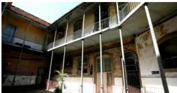
Figura 164 - Fotos do estado atual do inteiro da edificação, é possível notar o total estado de abandono. Fotografia: Marco Antônio Cavalcanti, 2013 Fonte: Cavalcanti, 2013.
