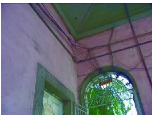
Figura 154 – A edificação possui grande quantidade de instalações elétricas mal feitas como a da foto acima, colocando o prédio em risco de incêndio. Fotografia: Desconhecido. Fonte: Plano Diretor, 2004.
