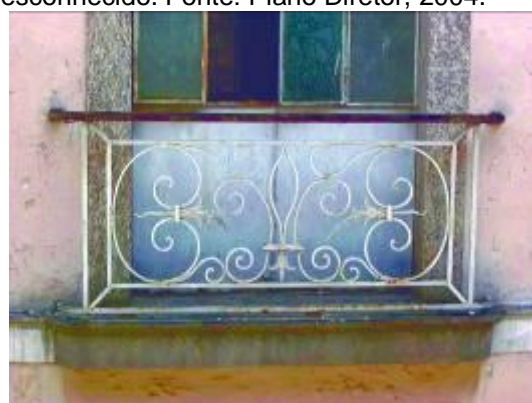
Figura 155 – Detalhe da Sacada do Bloco 5. Nota-se a presença de ferrugem danificando as peças em ferro. Fotografia: Desconhecido. Fonte: Plano Diretor, 2004.
