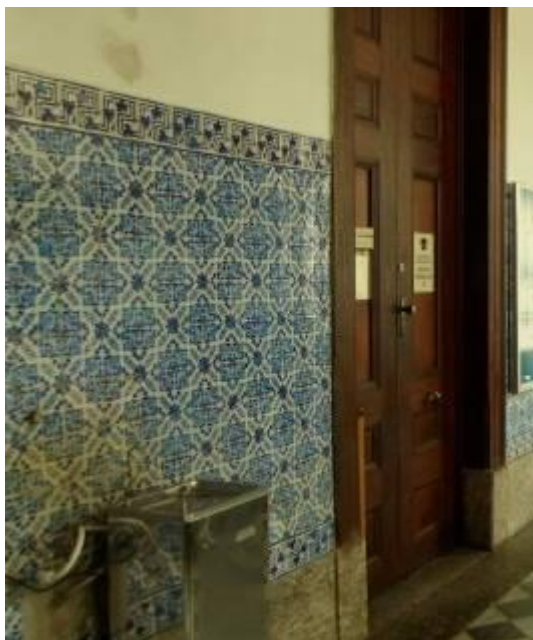
Figura 107 – Instalação do Bebedouro provocando infiltração e deixando manchas nos azulejos. Fotografia: Flávia Monteiro (2013) Fonte: Acervo Fotográfico Pessoal.
