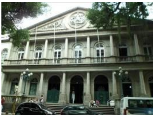
Figura 43 – Frontão e os detalhes artísticos da fachada apresentam bom estado de conservação, com apenas algumas manchas de umidade, que não comprometem a estrutura. Fotografia: Flávia Monteiro (2013) Fonte: Acervo Fotográfico Pessoal.
