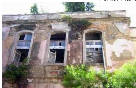
Figura 148 – Detalhe do Prédio 3 que está em alto estado de degradação. Nota-se as esquadrias danificadas, a falta de vidros, reboco faltante e inúmeras vegetações crescendo nas paredes e telhados. Fotografia: Desconhecido. Fonte: Plano Diretor, 2004.
