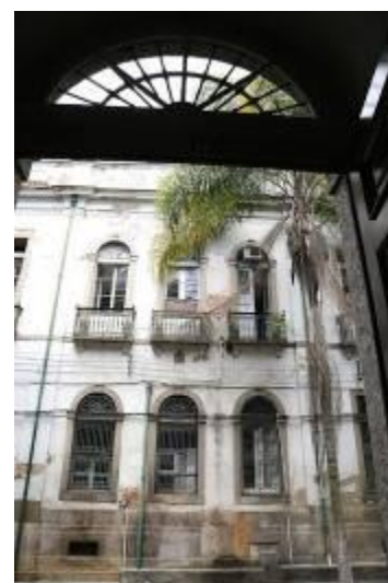
Figura 55 – Parte da Edificação vista por uma janela dos corredores. Nota-se que os danos no reboco, na pintura estão em todas as partes do hospital. Fotografia: Marco Antônio Cavalcanti. Fonte: Jornal O Dia, 2014.
