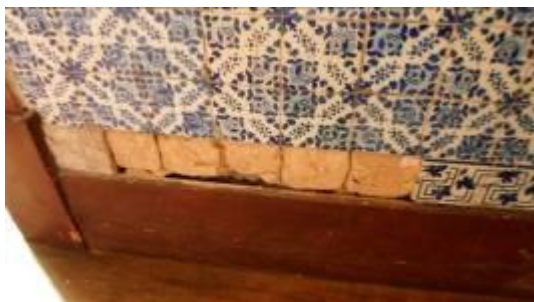
Figura 99 – Azulejo Português com descolamento em várias partes dos corredores. Fotografia: Flávia Monteiro (2013) Fonte: Acervo Fotográfico Pessoal.
