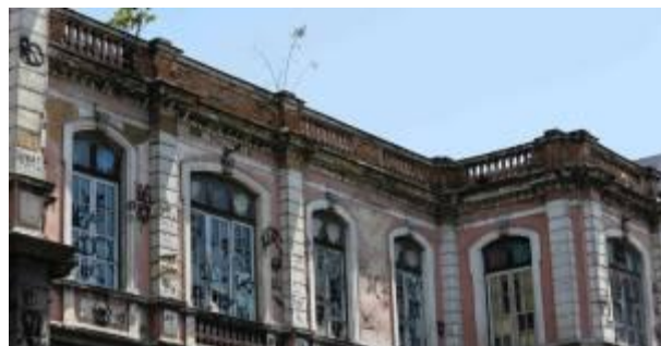
Figura 163 – Foto mostra as esquadrias e os vidros danificados. Fotografia: Marco Antônio Cavalcanti, 2013 Fonte: Cavalcanti, 2013.
