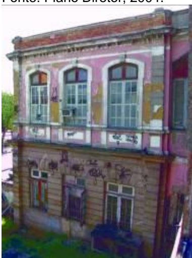
Figura 156 – Visada interna do pátio entre os pavilhões radiais. Nota-se que a edificação tem muitas pichações e danos na fachada. Fotografia: Desconhecido. Fonte: Plano Diretor, 2004.
