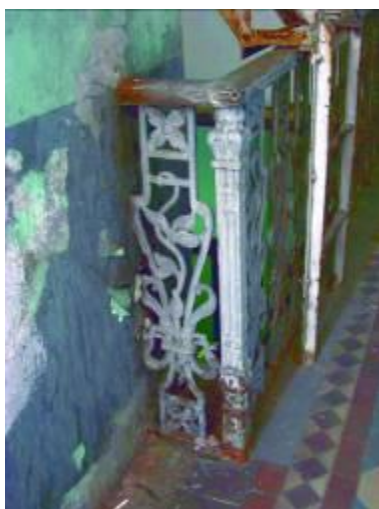
Figura 157 – Detalhe do guarda corpo em ferro interrompido para a construção de um elevador no prédio 7ª. Fotografia: Desconhecido. Fonte: Plano Diretor, 2004.
