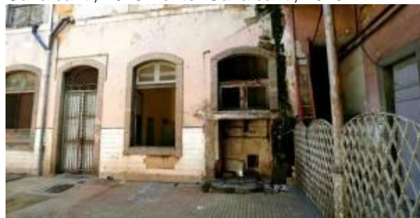
Figura 169 - Esquadrias das Janelas voltadas para a parte central da edificação estão bastante danificadas. Fotografia: Marco Antônio Cavalcanti, 2013 Fonte: Cavalcanti, 2013.
