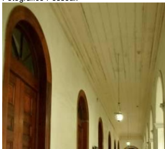
Figura 102 – Forro de madeira com manchas de umidade e desgaste na pintura. Fotografia: Flávia Monteiro (2013) Fonte: Acervo Fotográfico Pessoal.
