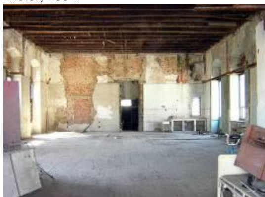
Figura 150 - Vista Interna do Pavimento Térreo do Prédio 3. No fundo da edificação pode-se observar a ligação com o anexo. Fotografia: Desconhecido. Fonte: Plano Diretor, 2004.
