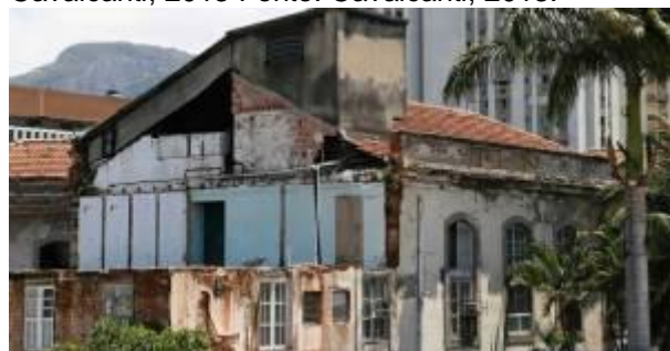
Figura 165 - Nessa imagem é possível observar que partes da edificação já estão em ruínas. Fotografia: Marco Antônio Cavalcanti, 2013 Fonte: Cavalcanti, 2013.
