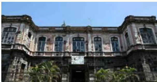
Figura 162 – Estado de conservação atual da fachada principal do Hospital. Fotografia: Marco Antônio Cavalcanti, 2013 Fonte: Cavalcanti, 2013.
