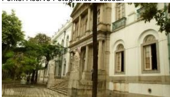
Figura 85 – Paredes da Fachada com pintura desgastada e manchada. Fotografia: Flávia Monteiro (2013) Fonte: Acervo Fotográfico Pessoal.
