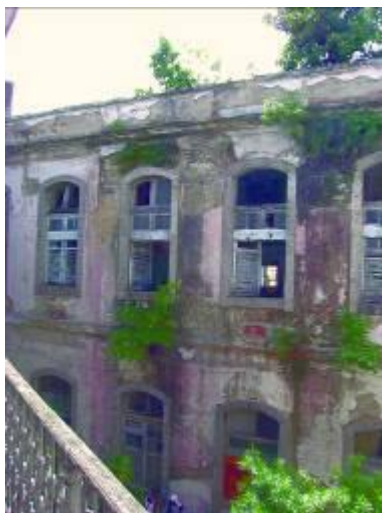
Figura 145- Vista Lateral do Prédio 3 onde pode se observar o péssimo estado de conservação. Fotografia: Desconhecido. Fonte: Plano Diretor, 2004.
