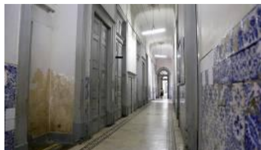
Figura 50 – Vista de um dos corredores do andar térreo. Pode-se notar grandes danos no revestimento, reboco e pintura, das paredes. Os Azulejos Portugueses apresentam-se em péssimo estado, com muitas peças perdidas, quebradas ou manchadas. Fotografia: Marco Antônio Cavalcanti. Fonte: Jornal O Dia, 2014.
