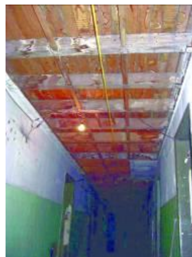
Figura 158 – Interior do Prédio 1. Nota-se a precariedade das instalações elétricas e a falta de forro no teto. Fotografia: Desconhecido. Fonte: Plano Diretor, 2004.
