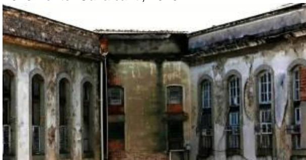
Figura 166 – A pintura externa e o reboco das paredes e platibandas apresentam-se em estado de conservação ruim. Fotografia: Marco Antônio Cavalcanti, 2013 Fonte: Cavalcanti, 2013.
