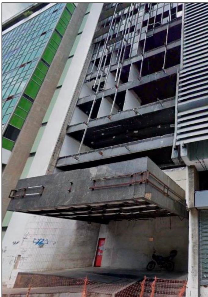
Figura 25 – Imóvel na Avenida Jerônimo com alto grau de degradação
