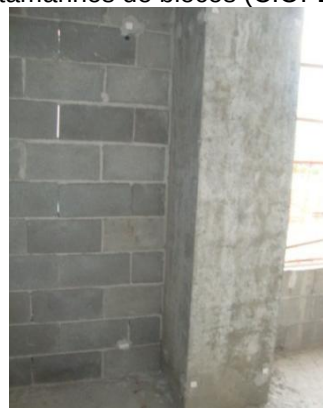
Figura 22 – Parede executada com diferentes tamanhos de blocos (C.O.-1)
