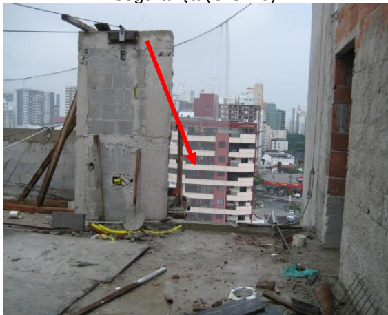
Figura 52 – Inexistência equipamento segurança (C.O. -9)
