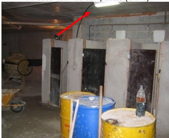
Figura 15 – Utilização de lâmpadas fluorescentes não compactas (C.O-9)
