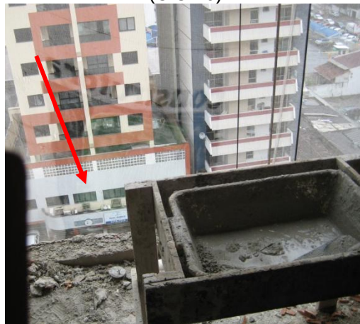
Figura 53 – Inexistência equipamento segurança (C.O. -9)
