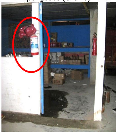
Figura 44 – Armazenamento de materiais perigosos (C.O.-8)
