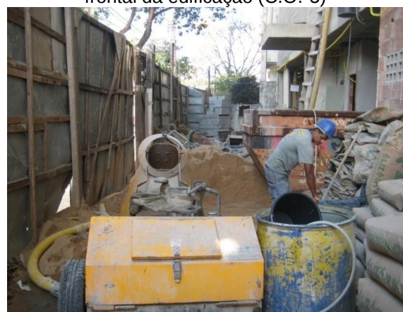
Figura 26 – Materiais a granel no afastamento frontal da edificação (C.O.-5)
