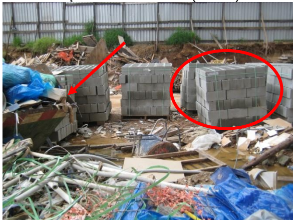
Figura 27 – Blocos estocados ao lado de caçambas de resíduos (C.O.-8)
