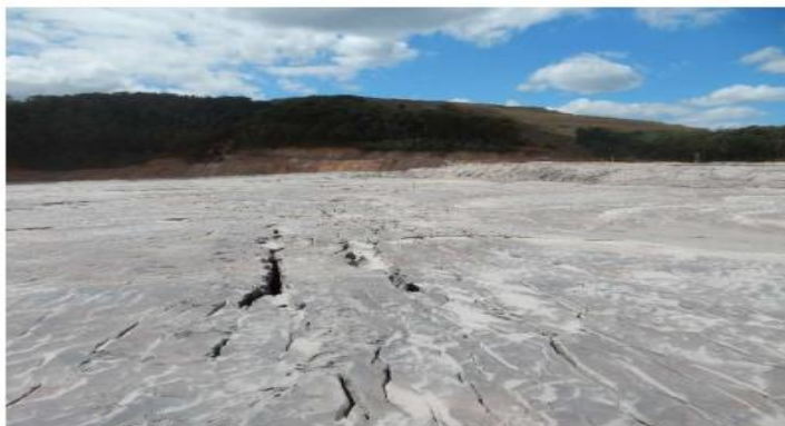
Figura 35 – Trincas no topo, paralelas à crista, dentro do reservatório – setembro/2014
