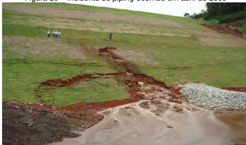
Figura 20 – Incidente de piping ocorrido em abril de 2009
