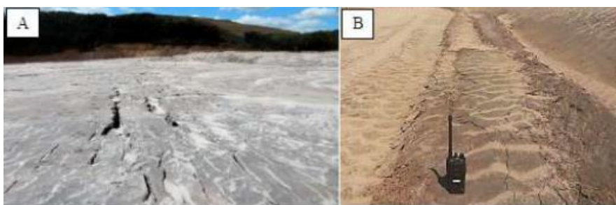
Figura 34 – Sinais de pré-ruptura da barragem de Fundão (agosto/2014)
