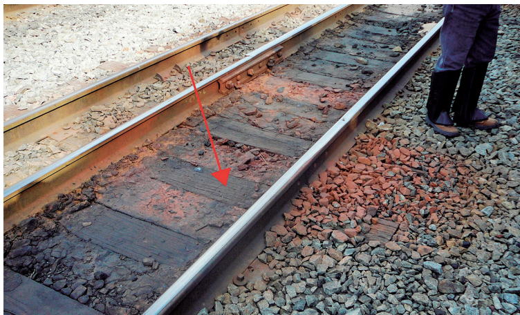
Figura 248 – Material da plataforma aparecendo no lastro por conta do laqueado
