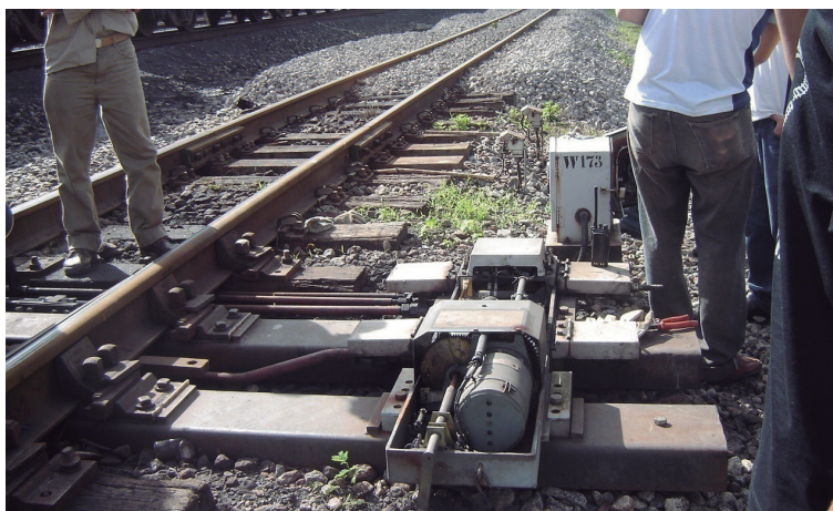
Figura 193 – Chave com acionamento elétrico aberta mostrando o motor
