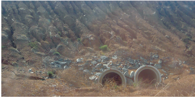
Figura 81 – Bueiro de grotta duplo de seção circular com tubos de concreto
