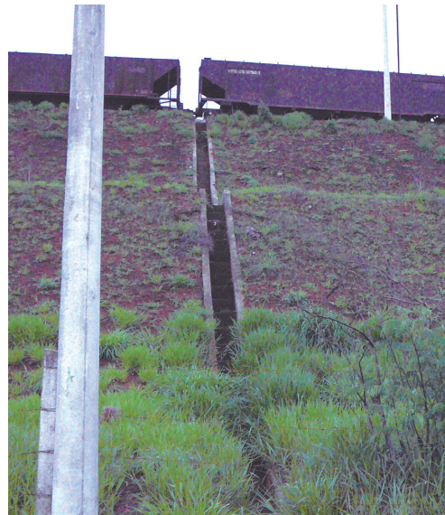
Figura 95 – Escada d'água passando por bermas de um corte
