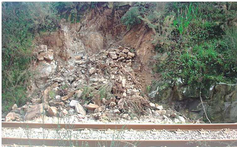
Figura 31 – Escorregamento de parte do talude
