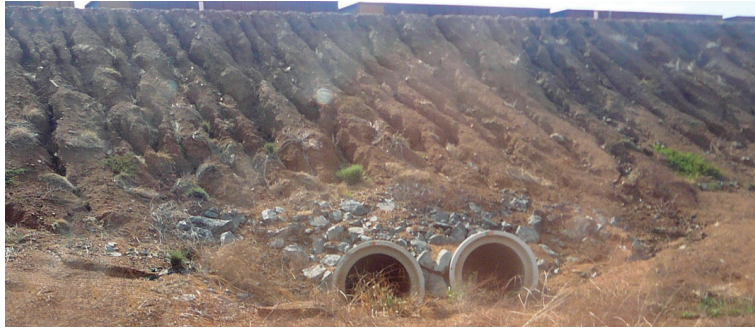
Figura 49 – Erosão em sulcos
