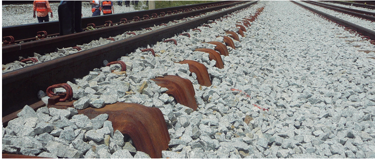
Figura 257 – Desmoronamento da ombreira de lastro
