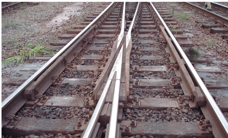
Figura 175 – Detalhe do contratrilho e do jacaré instalado
