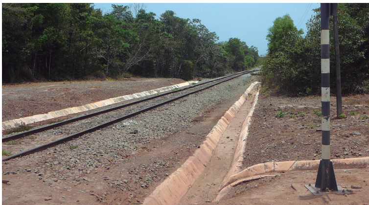
Figura 86 – Canaletas de pista
