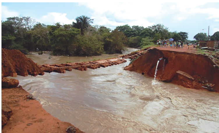
Figura 76 – Bueiro de grota rompido com o aterro destruído e grade da ferrovia suspensa
