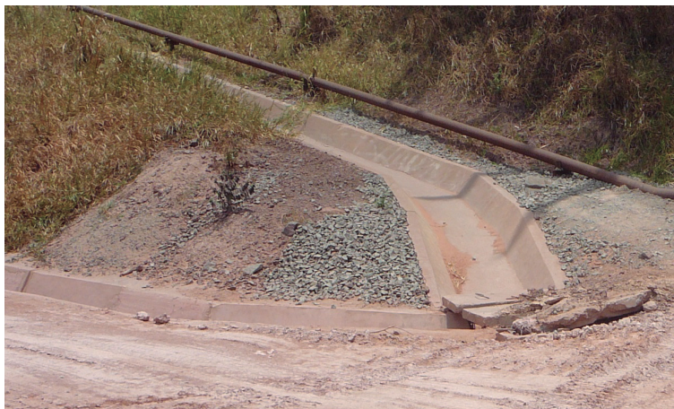
Figura 90 – Caixa de transição
