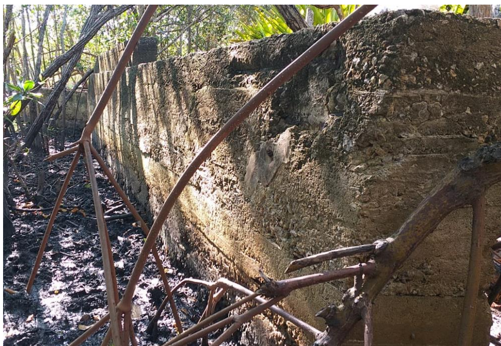
Fotografia 13 – Estrutura frontal do porto da Cimbarra na Ilha das Cobras (Mureta com aproximadamente 18 metros de comprimento por 50 cm de largura)
