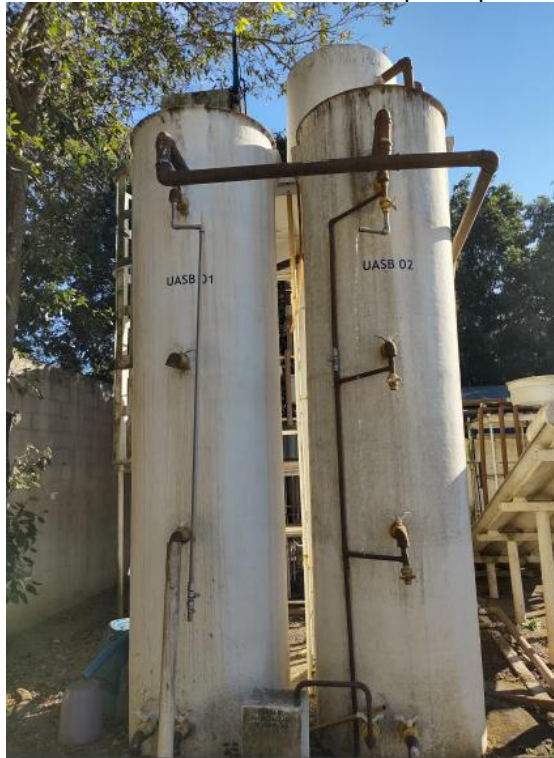
Figura 6.2 – Reatores UASB localizados no Parque Experimental de Araçás.
