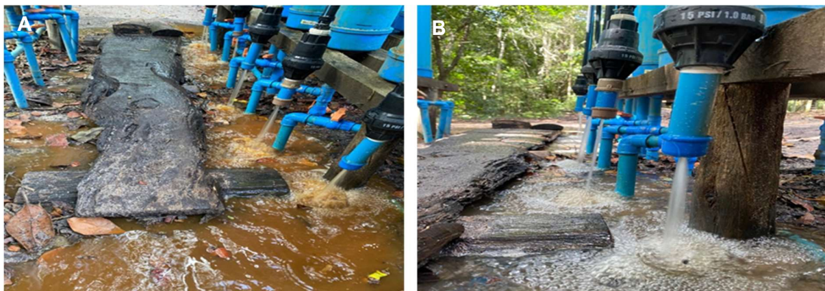
FIGURA 4. (a) Início da retrolavagem com alto índice de ferro nos filtros, (b) final da retrolavagem.
