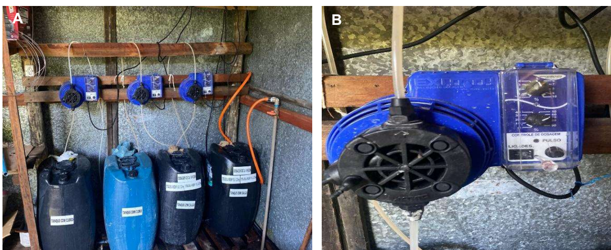
FIGURA 3. Dosadora. (a) esquema de armazenamento de CaO e Ca (ClO) 2 , (b) bomba dosadora para injeção de CaO e Ca (ClO) 2 .
