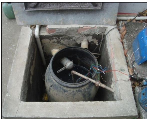
Figura 18. Reservatório de água cinza bruta.
