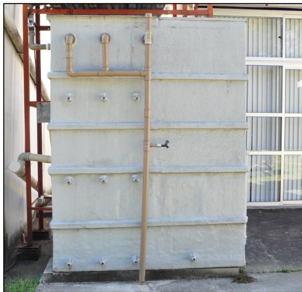
Figura 13. Filtro anaeróbio de fluxo ascendente.
