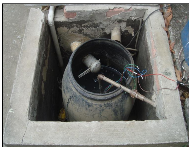
Figura 12. Peneira instalada na tubulação canalizadora de água cinza.
