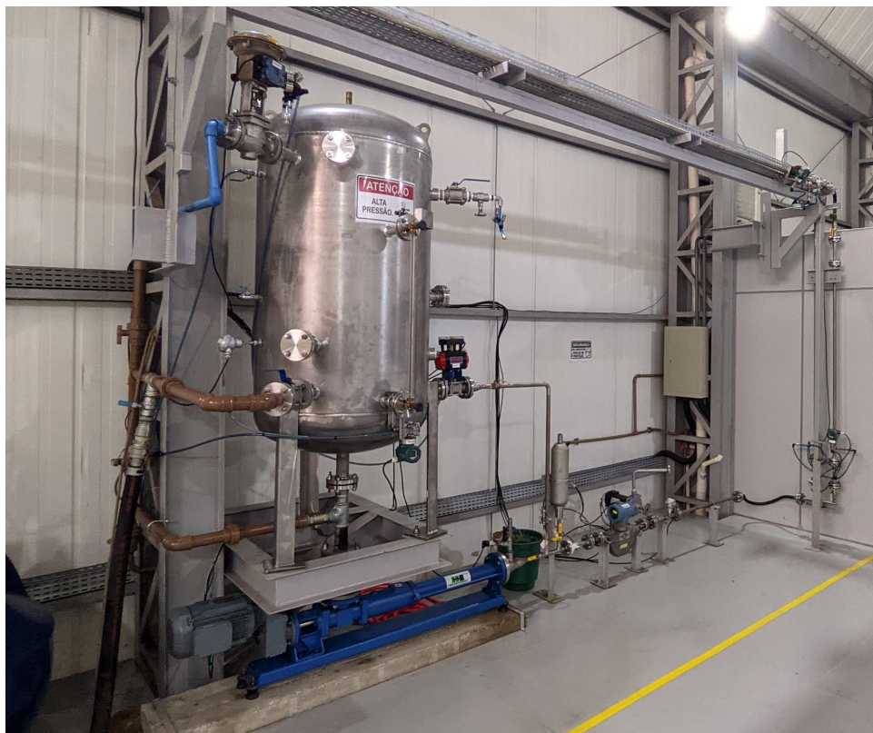
Figura 10 – Fotografia de trecho do circuito, montado e operante.
