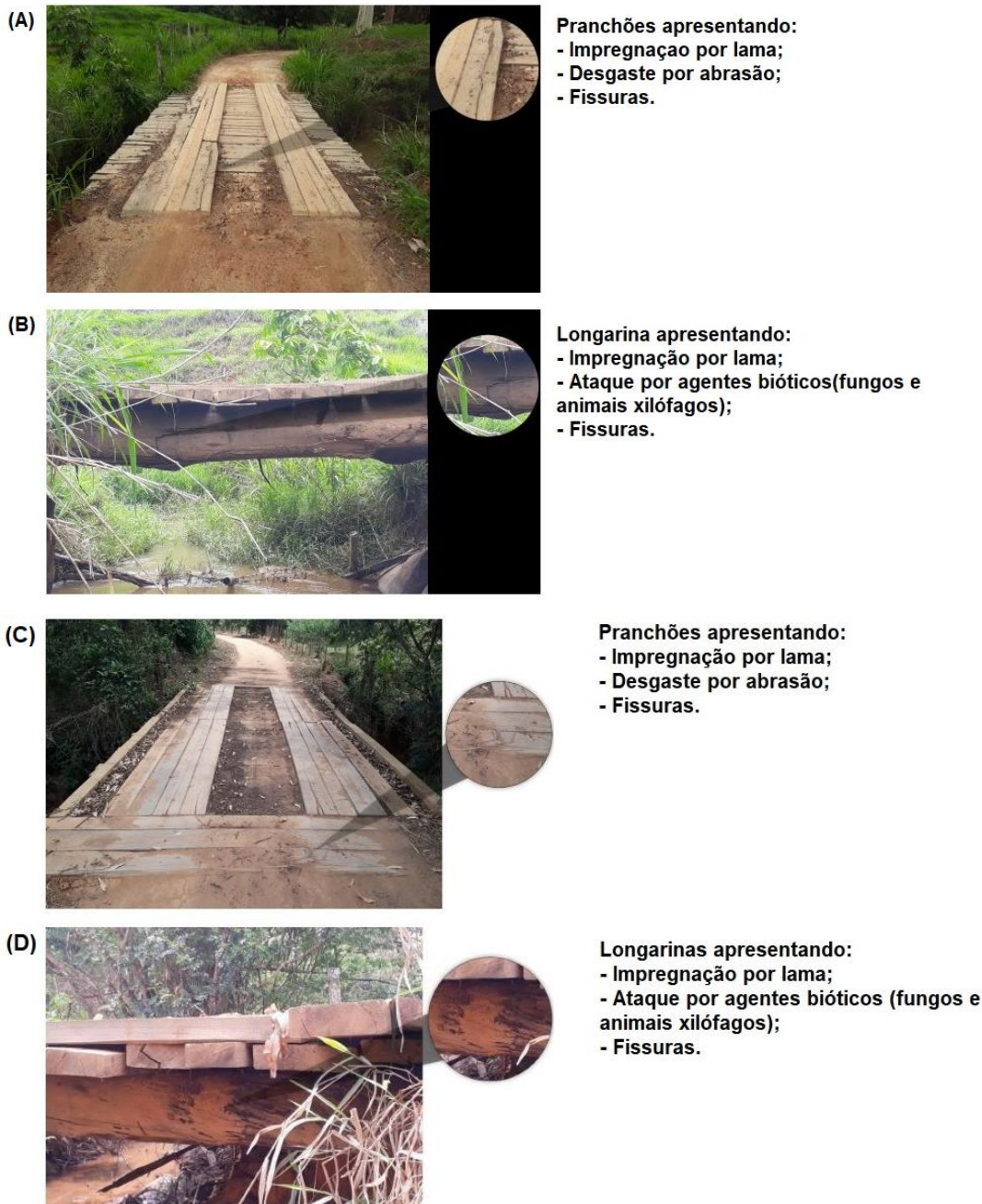
Figura 15. Pontes atacadas por agentes bióticos e abióticos: A e C pranchões impregnados por lama, desgaste a abrasão e fissuras; B e D longarina apresentando fissura, ataque por agentes bióticos e impregnação por lama.
