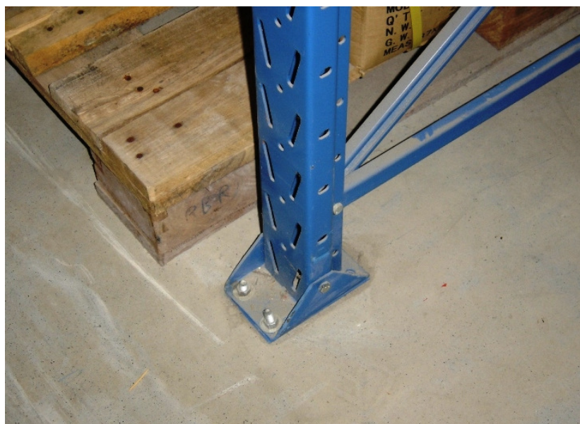
Figura 3.16 – Foto da placa de base parafusada no piso.
