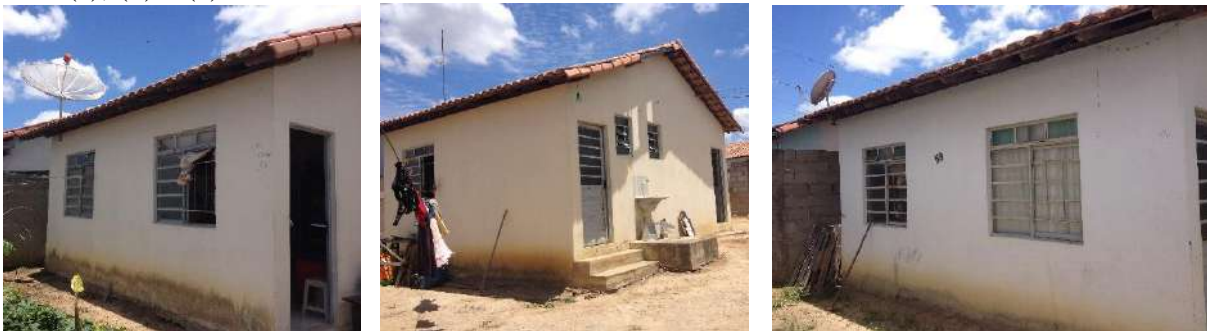
Figura 28. Ausência de calçada no entorno das edificações e sinais de umidade ascendente em (a), (b) e (c).
