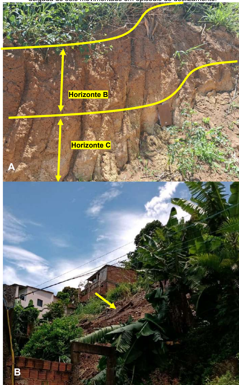
Figura 17– Incidência típica dos solos no Maciço de Jaburuna, Vila Velha – ES. Coordenadas UTM – Datum Sirgas 2000. 364041,730E; 7751668,667N (A). 363766,318E; 7751171,871N (B). Em (A), representação gráfica (em amarelo) aproximada dos horizontes B e C verificados em talude de corte. Em (B), seta amarela indicando afloramento rochoso sob camada delgada de solo movimentado em episódio de deslizamento.
