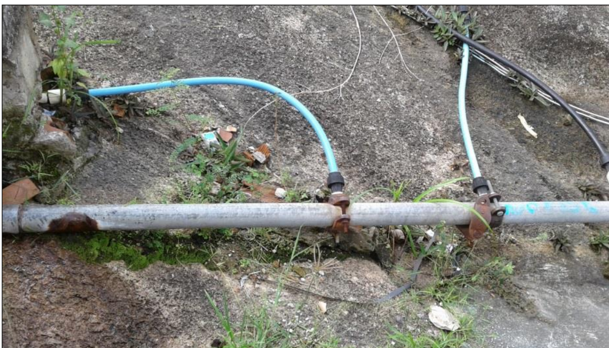
FIGURA 24 – CONDIÇÕES DE INFRAESTRUTURA FAVORÁVEIS AOS VAZAMENTOS.
