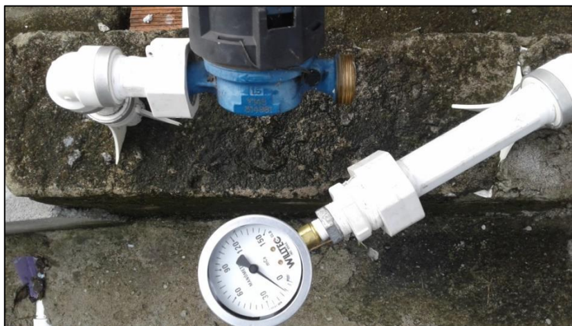
FIGURA 27 – MEDIÇÃO INSTANTÂNEA DE PRESSÃO EM CAVALETE.
